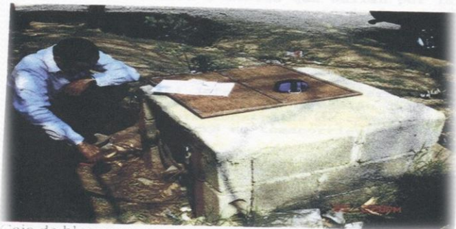
Caja de bloques y concreto, tapadera metálica con cerradura.
