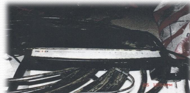
Switch y cableado.
