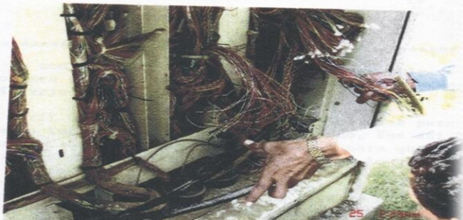
3 cables 50X24 conectados. 2 secundarios 1 primario.
